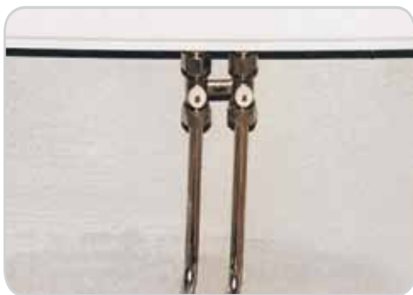
Povezava z radiatorskim lokom
