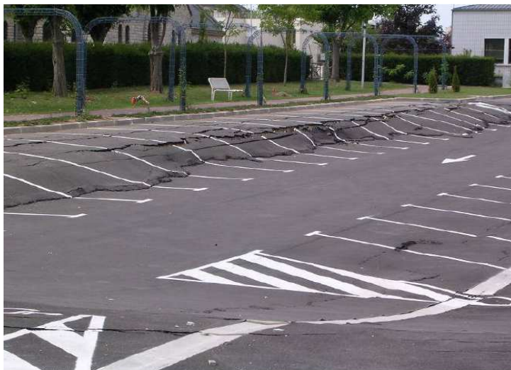
Slika 3: Posledica vgradnje neprimernih ponikalnih blokov
